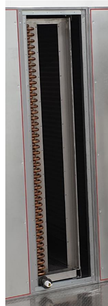
Im RLT installierte Wärmetauschereinheit mit gezogenem Tropfenabscheider
